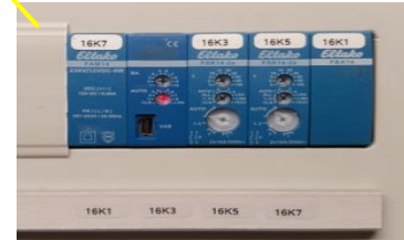
Relais für PV-Optimierung (WP+Boiler+Haushaltgeräte)
